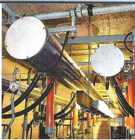
Die beiden Puffertanks wurden aufgehängt, um eine Schallübertragung zu verhindern.
